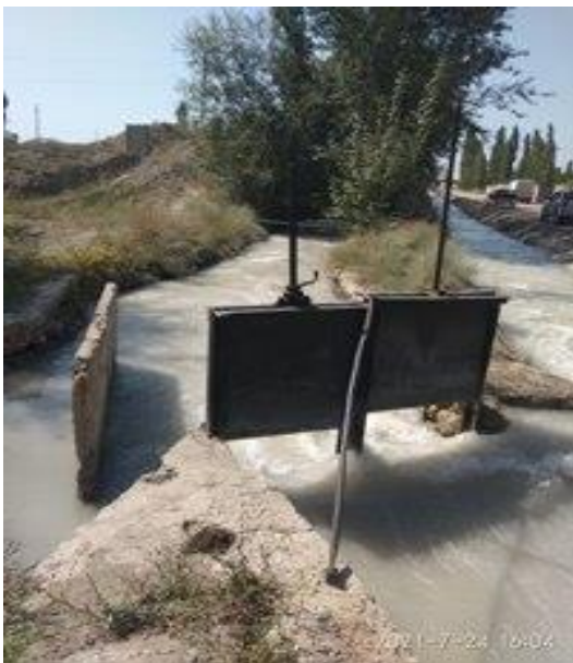
Рисунок 7. Водовыпуск на ПК144+39 (Отвод в канал Алга)
