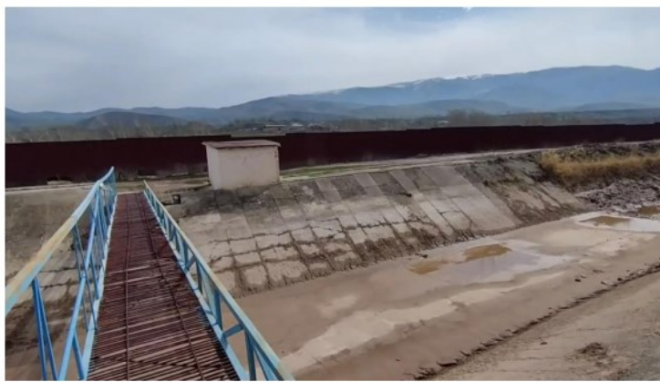
Рис 6. Гидропост на ПК6+20
